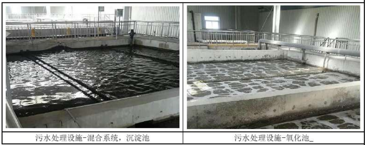
图 1-15 废水处理站处理设施
